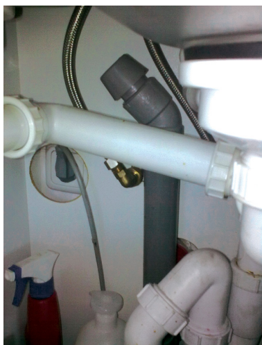
Figuur 17.9 Foutief geplaatste beluchter. Dit is de donker grijze buis; de beluchter is niet verticaal geplaatst en gaat daardoor lekken, met stankoverlast tot gevolg.
